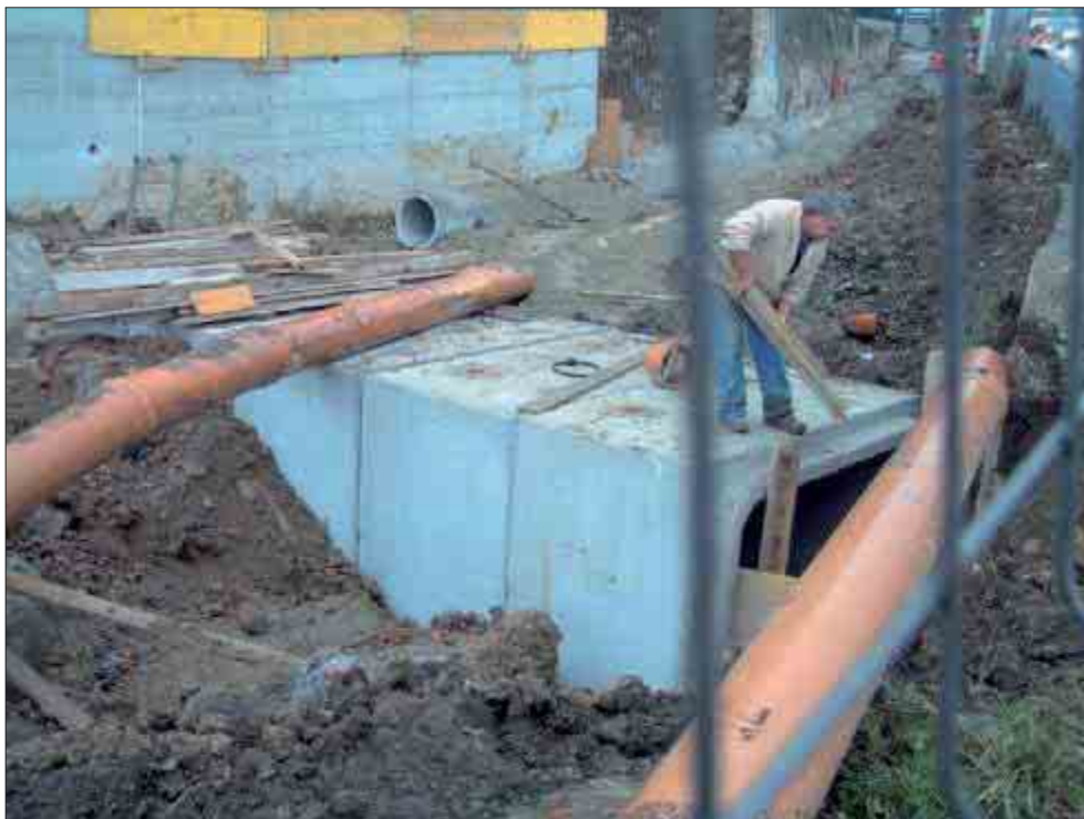
Foto 4 – costruzione della struttura scatolare a monte della Via Chieri e suo collegamento con il sottopasso stradale. Si nota sullo sfondo la tubazione di raccolta delle acque che saranno immesse nel canale.
