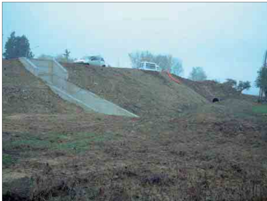
Foto 3 – scarpata di valle della rotonda viaria in costruzione con sbocco della struttura scatolare di sottopasso stradale
