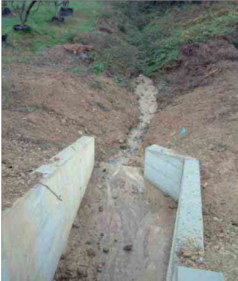
Foto 2 – Sbocco della struttura scatolare di sottopasso della rotonda viaria in costruzione con innesto nel fossato preesistente
