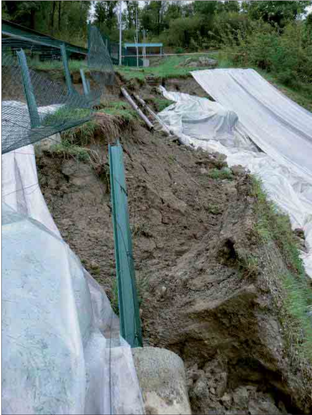
Movimento franoso innescatosi a seguito delle intense precipitazioni piovose del 25÷28/04/2009 che ha coinvolto un tratto delle le strutture dell'impianto a fune di risalita all'osservatorio astronomico di Pino Torinese
